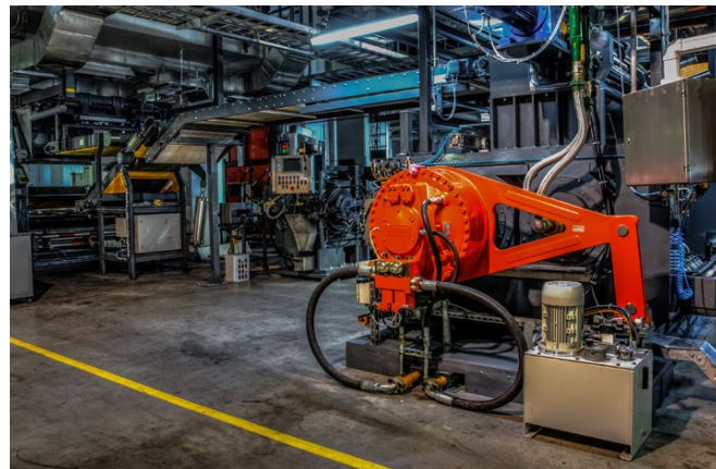
Firma PTE dysponuje obecnie prawie 50 systemami napędowymi Hägglunds, które stanowią integralną część jej instalacji produkcyjnych.
