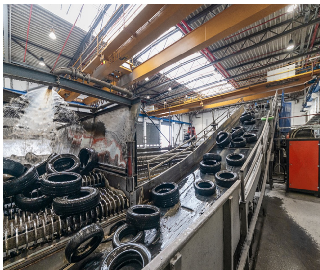
▲ Silniki i systemy napędowe Hägglunds stanowią integralną część działalności Genan i są wykorzystywane we wszystkich zakładach firmy.
